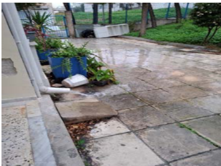
Εικόνα: Το δίκτυο απορροών των νερών που καταλήγουν στο προαύλιο χωρίς να απομακρύνονται
