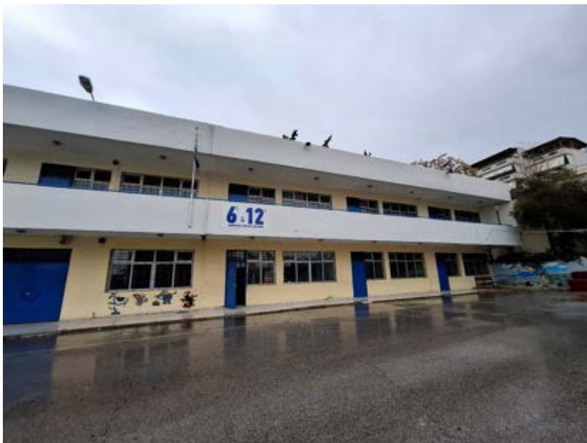
Εικόνα: Λιμνάζοντα νερά στο προαύλιο του σχολείου
