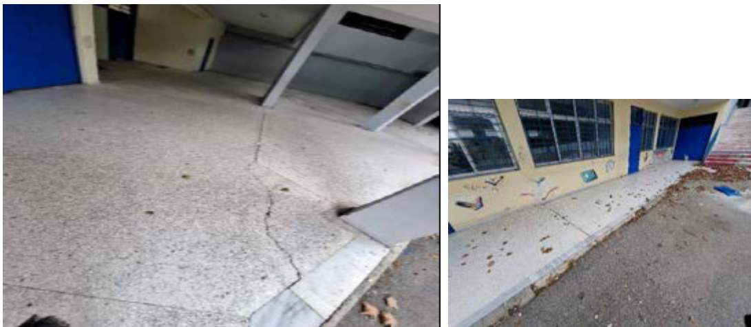
Εικόνα: Ρωγμές στο μωσαϊκό του δαπέδου
