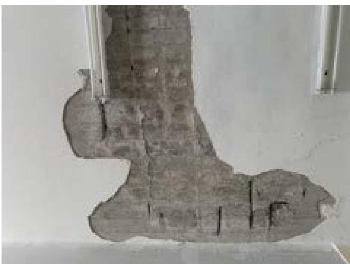
Εικόνα: Αποκόλληση τεμαχίων σκυροδέματος επικαλύψεων σπλισμών από την πλάκα οροφής της θέσης ανάμεσα στο Κτίριο III και IV και των τοιχίων
