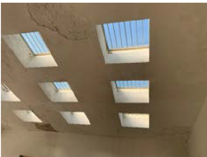
Εικόνα: Αποκόλληση τεμαχίων σοβάδων από την πλάκα οροφής του αιθρίου
