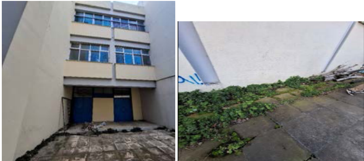
Εικόνα: Έντονη υγρασία και βλάστηση στο δάπεδο λόγω των υδάτων
