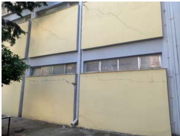
Εικόνα: Οι διαγώνιες ρωγμές στη βορινή όψη του κτιρίου III στην εξωτερική πλευρά
